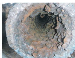
写真1 スキッド内部閉塞状況 Photo 1 Blockage of the skid pipe
